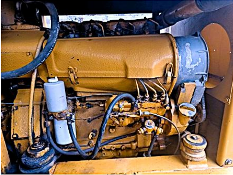
Fotografía No. 5 Vista Motor
