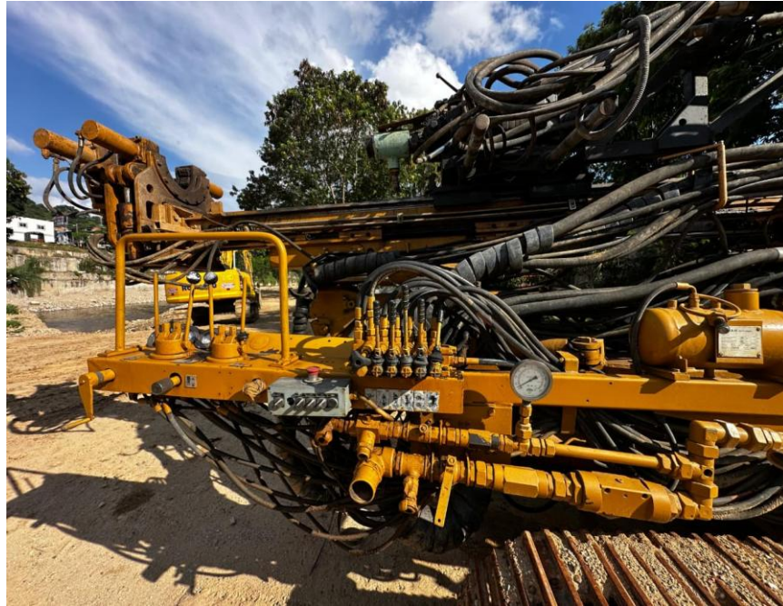
Fotografía No. 5 Vista Controles
